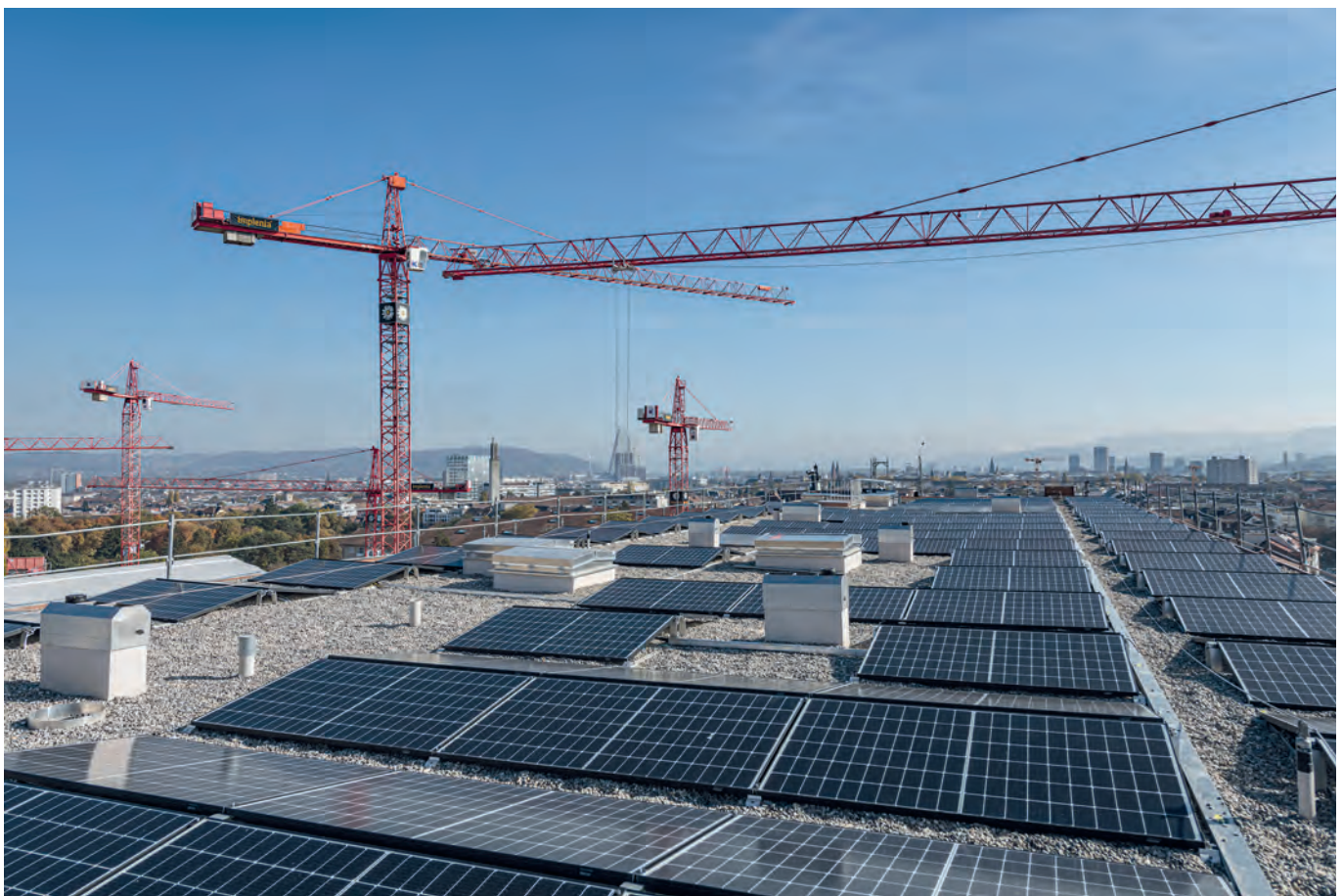
Die Photovoltaikanlage auf dem Dach des Schiffs wurde im 2021 fertig installiert.
