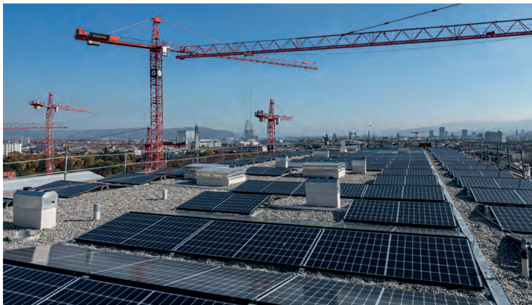
Die Photovoltaikanlage auf dem Dach des Schiffs ist bereits fertig installiert.
